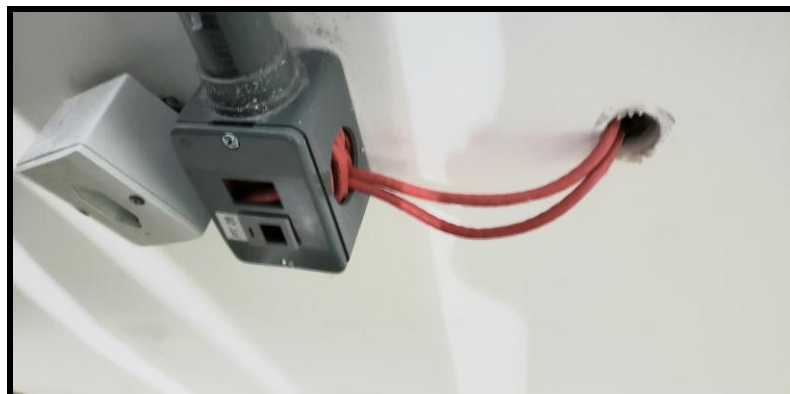
Figura 15: Passagem improvisada do cabeamento
