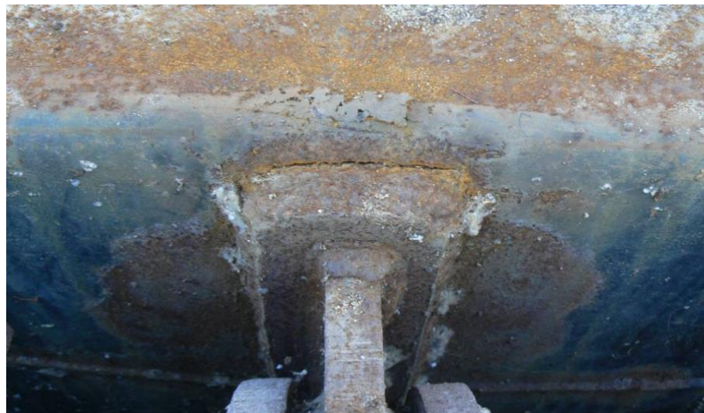
Figura 40 – Trincas propagadas devido ao trabalho da peça. Fonte: SANCHES, 2010.
