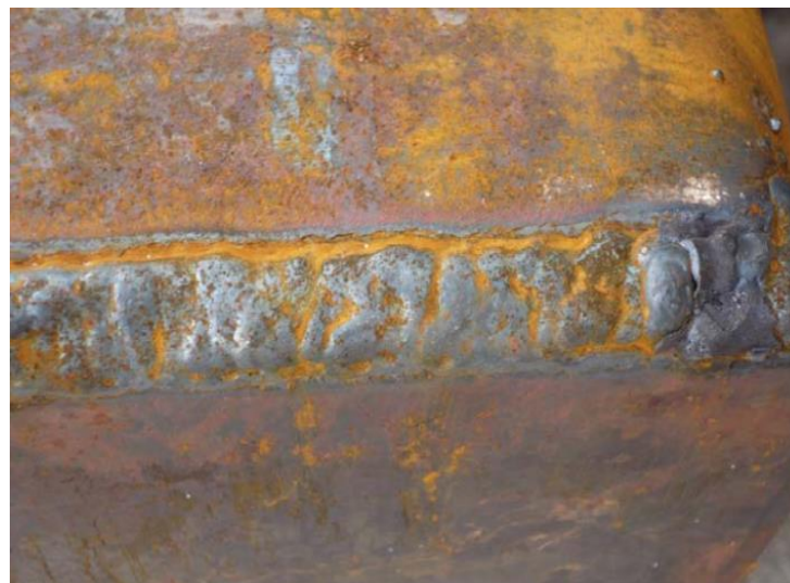
Figura 39 – Mordeduras no cordão de solda. Fonte: SANCHES, 2010.
