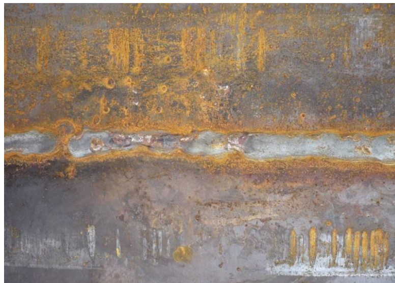
Figura 35 – Falta de penetração em parte do cordão de solda. Fonte: SANCHES, 2010.
