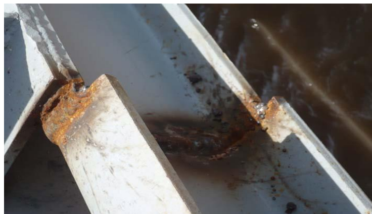
Figura 32 – Junta incorreta. Fonte: SANCHES, 2010.
