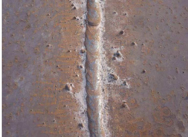
Figura 37 – Excesso de respingos I. Fonte: SANCHES, 2010.
