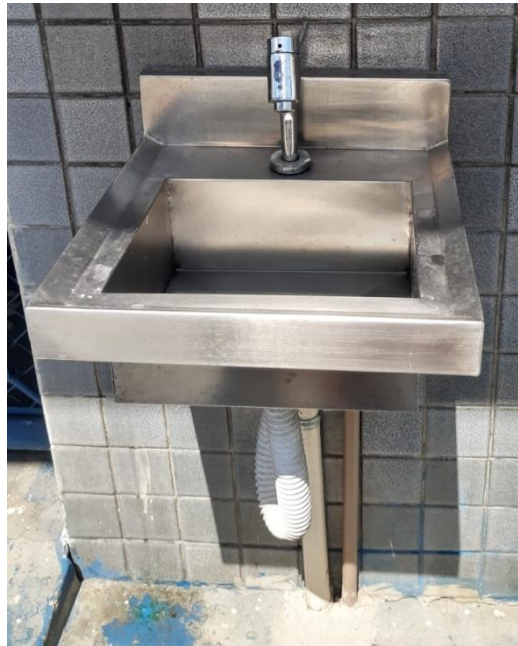
Figura 7: Pia instalada na escola
