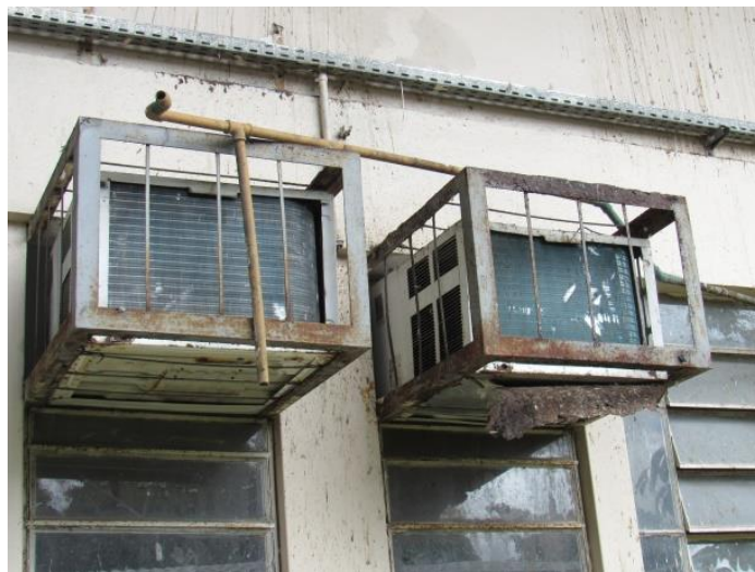
Figura 13: Condicionador de ar sem dreno
