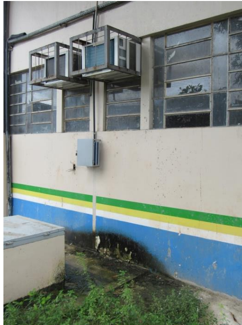
Figura 14: Pintura danificada e criação de incrustação (lodo)
