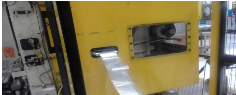
Figura 6 - Sistema de Proteção de Prensas por Ferramenta Fechada
