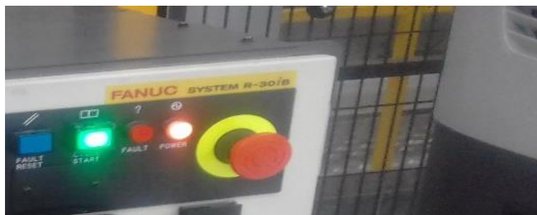
Figura 20 - Painel com Botão de Parada de Emergência
