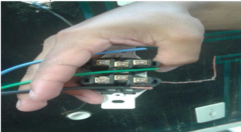
Foto 18: fios que serão conectados na tomada
