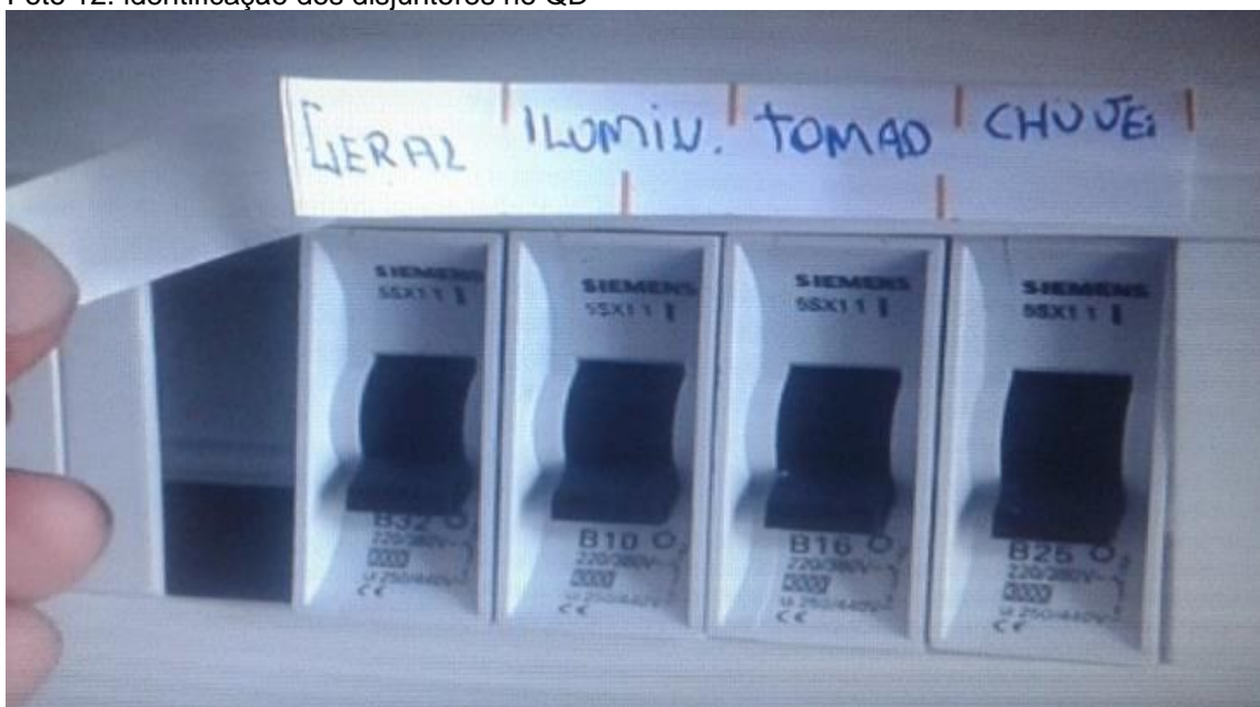
Foto 12: identificação dos disjuntores no QD
