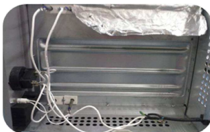
Elementos elétricos da parte externa do forno.
