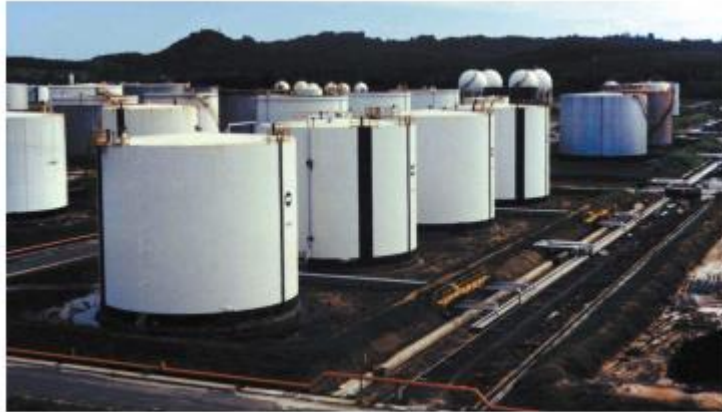
Figura 11- Vista de tanques de teto fixo em um parque de armazenamento de combustíveis
