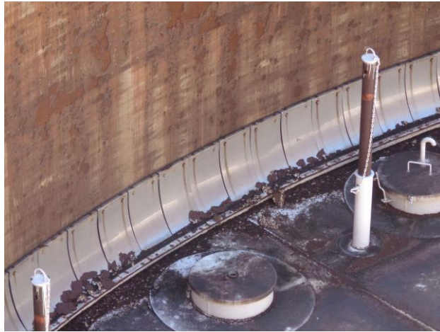
Figura 28- Sistema de selagem do tanque G-03
