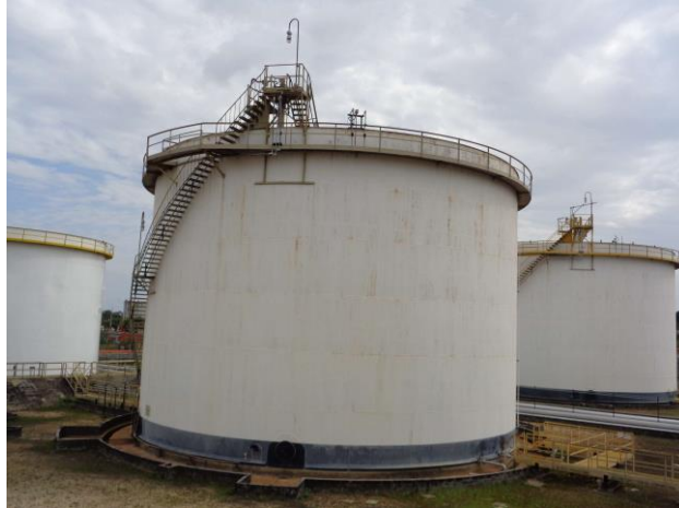
Figura 25- Vista geral do tanque G-03 no parque de armazenamento de combustíveis
