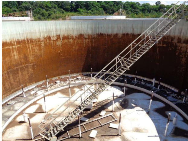
Figura 27- Estado da pintura na superfície interna do costado do tanque G-03
