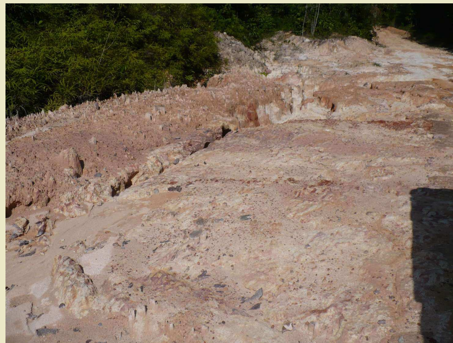
Figura 9. Erosão do tipo ravina localizada no Km 60 da BR -174, Manaus/AM
