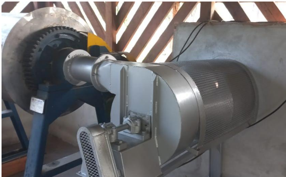
Figura 3: Sistema de ventilação forçada
