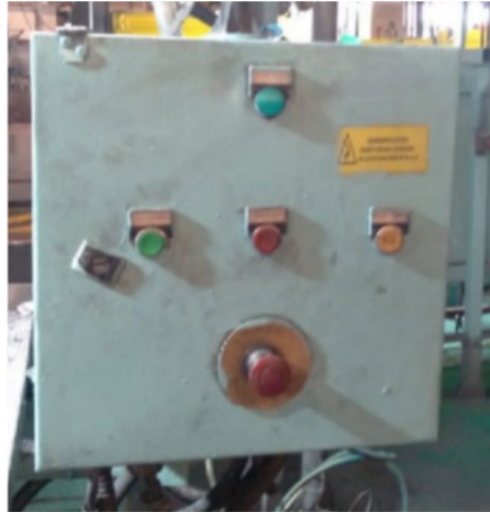
Figura 6 - Frontal do painel elétrico
