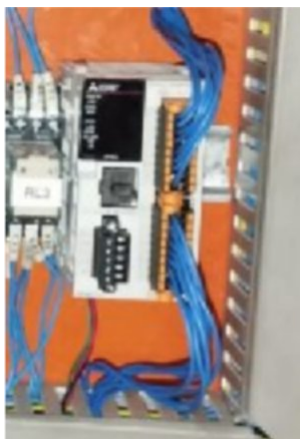
Figura 19 – Instalação do CLP Fonte: Autor (2025)
