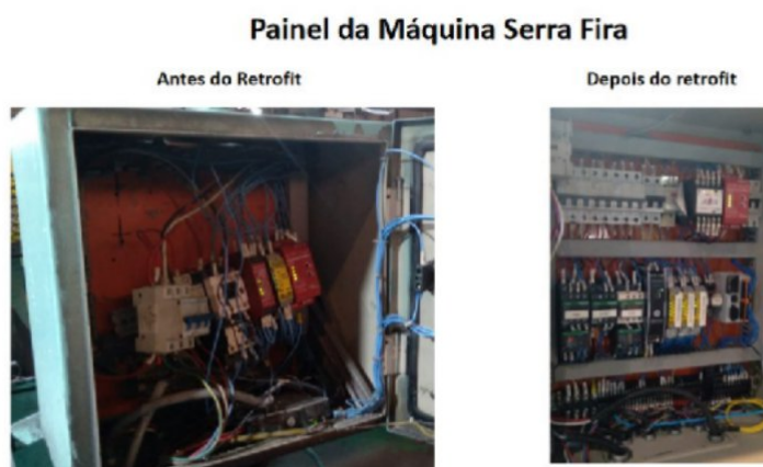
Figura 18 – Painel elétrico da máquina
