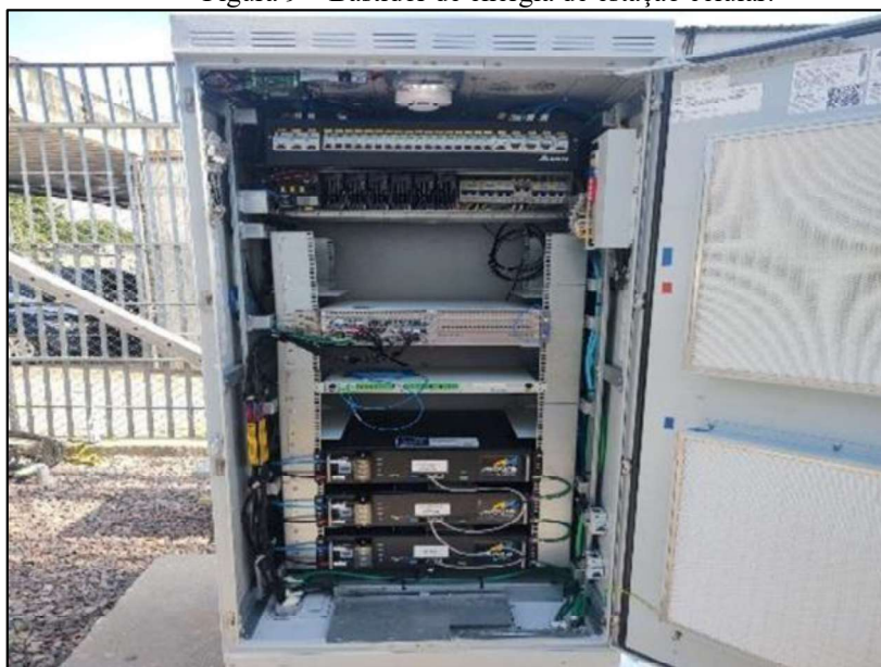
Figura 9 – Bastidor de energia de estação celular.
