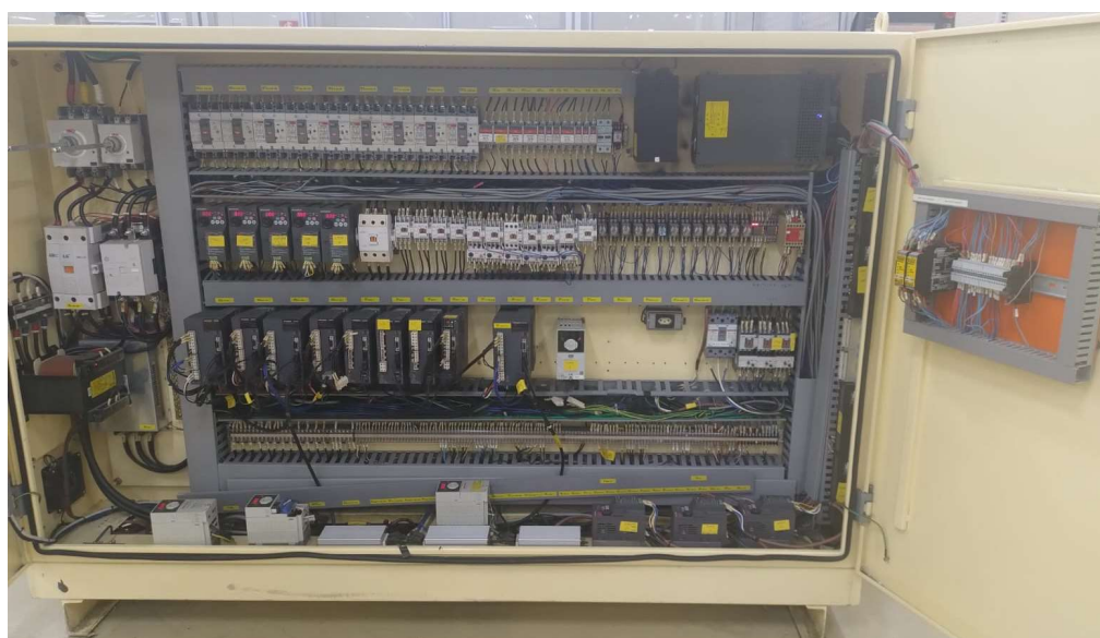
Figura 6- Painel de força e comando das esteiras
