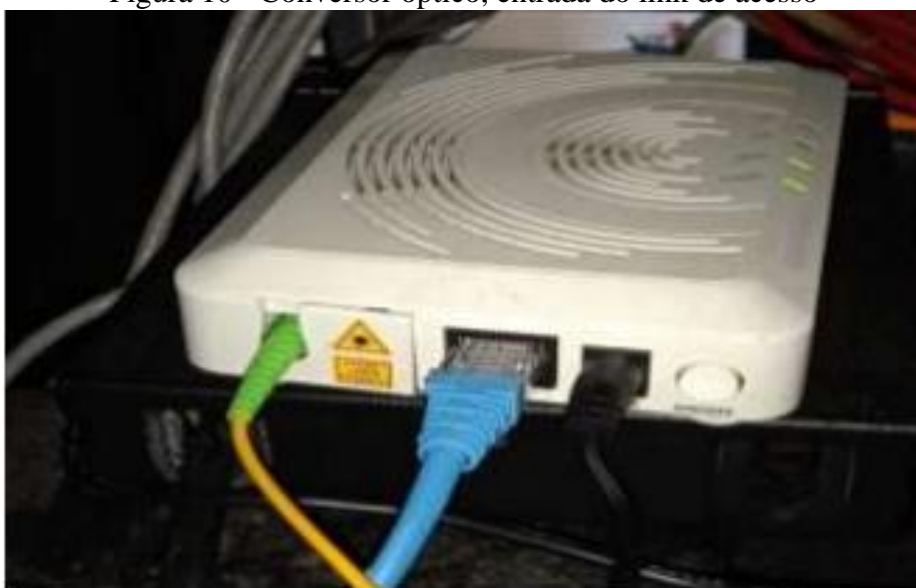
Figura 10 - Conversor óptico, entrada do link de acesso
