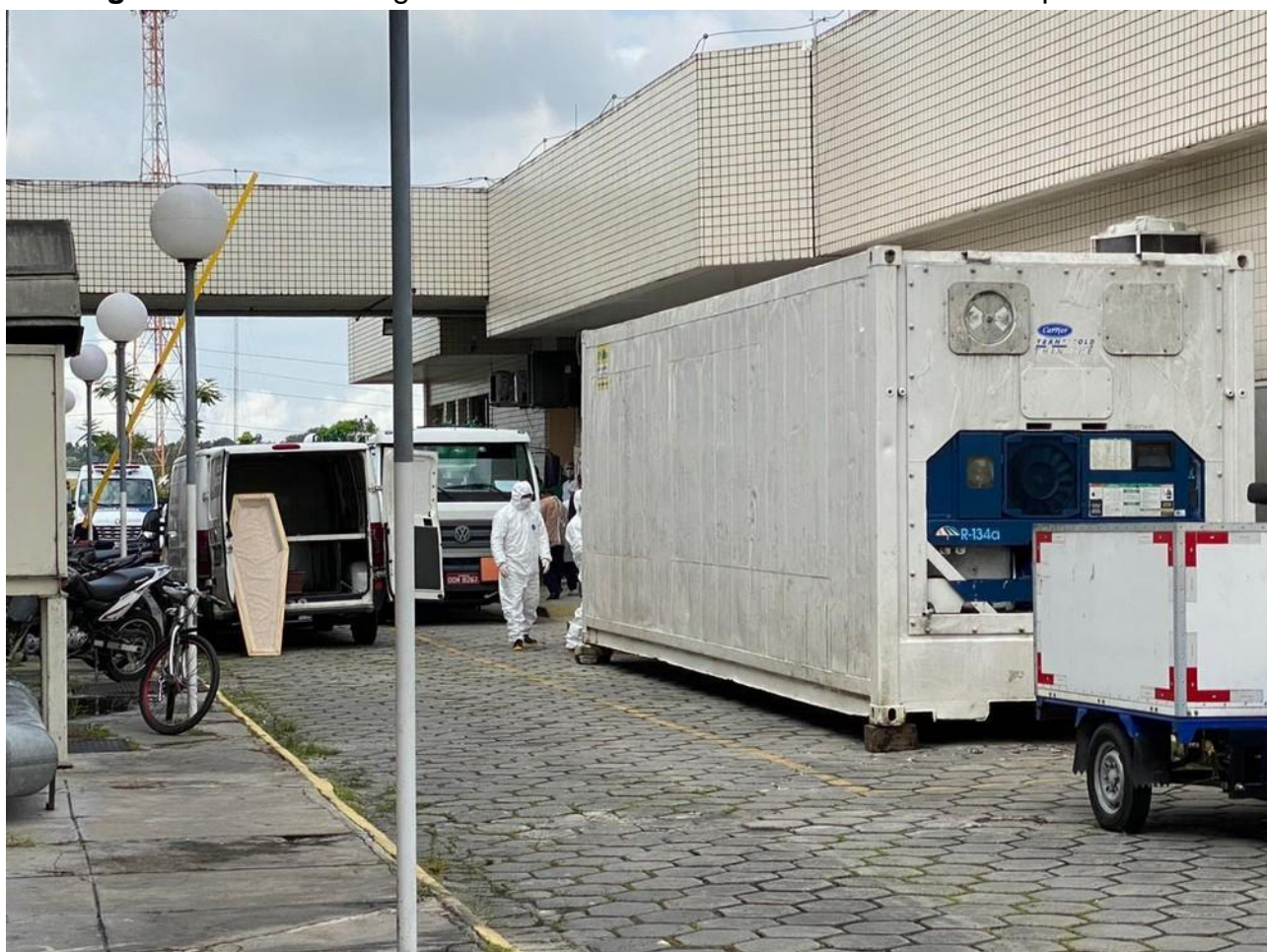
Figura 7 - Câmaras frigoríficas instaladas no estacionamento de hospital em
