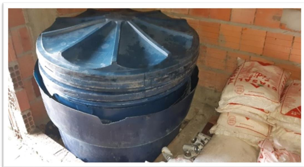
Imagem 2 - Insumos armazenados forma inadequada e em locais inapropriados
