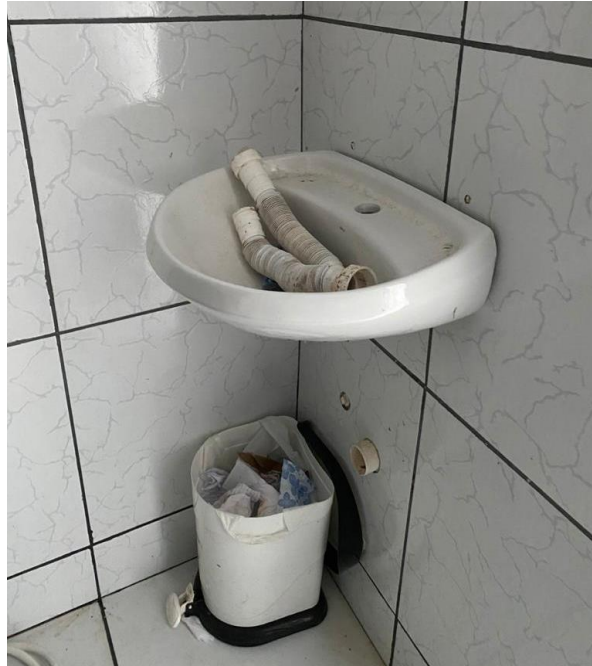
Figura 6 - Banheiro com pia e lixeira quebradas classificando não conformidades. Fonte: Autoria própria.
