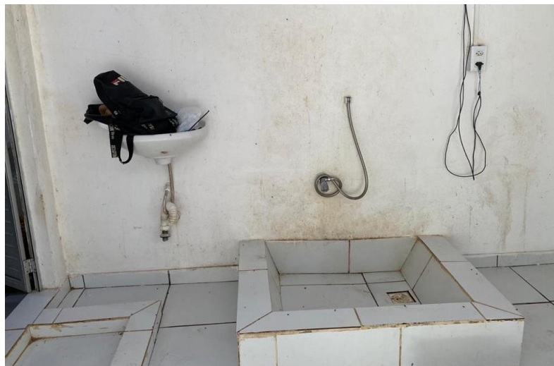
Figura 18 - Bloqueio sanitário sem lavador de botas e sem torneira para lavar mãos.
