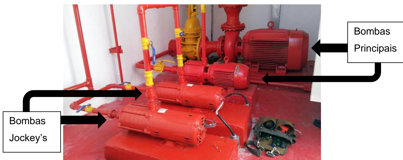
Figura 6 - Bomba de incêndio e bomba jockey
